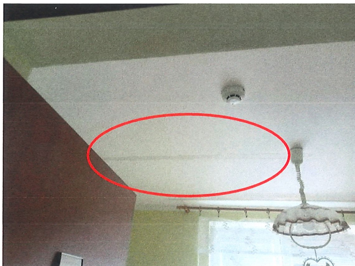
Viditelné zatečení do podkrovního pokoje/strop SDK.
