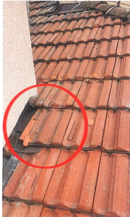
Pohled na střešní krytinu a oplechování komína. Nevhovující oplechování a rozpadající se střešní krytina.
