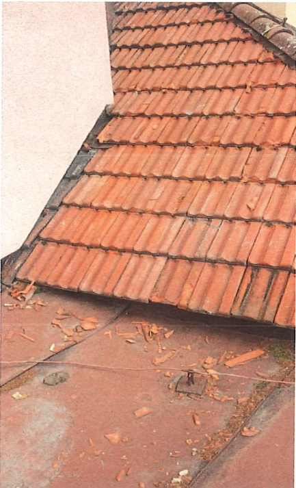
Pohled na rozpadající se střešní krytinu, úlomky padají ze střechy na okolní plochu plochu. je nefunkční a odporuje technickým zásadám řádné opravy.
