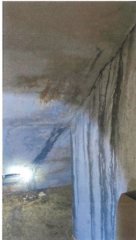
Pohled na vnitřní podhled podkrovních prostor/půda a komínové těleso. Dochází k zatékání do konstrukcí střechy a vnitřních částí.
