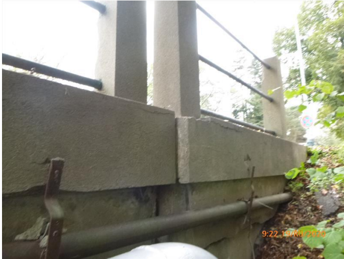
Održení části pravého křídla a římsy.
