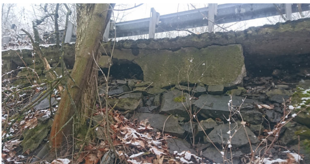
Destrukce zdiva a zhlaví levé opěrné zdi
