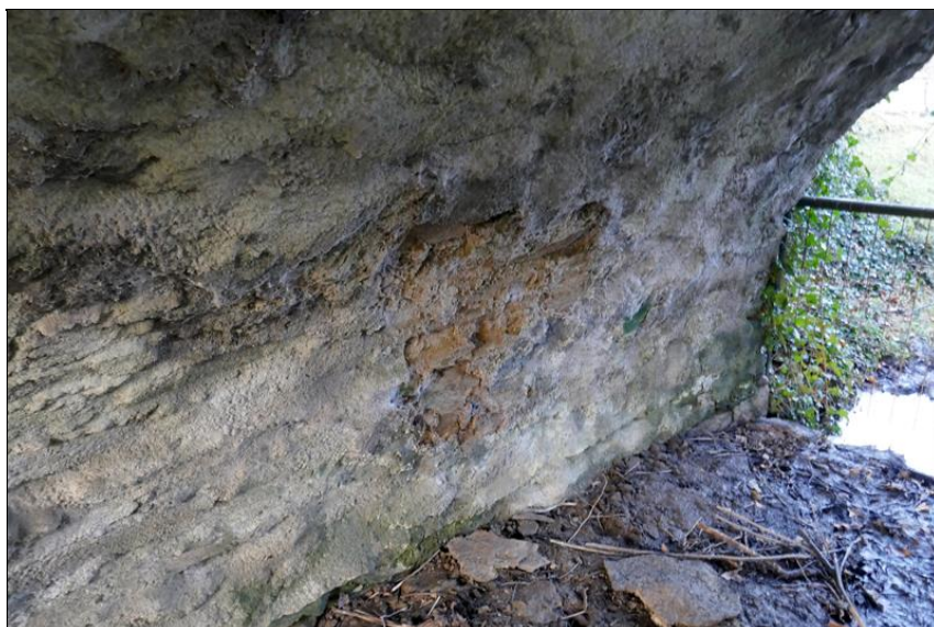
17_odpadla omítka na OP2.jpg
