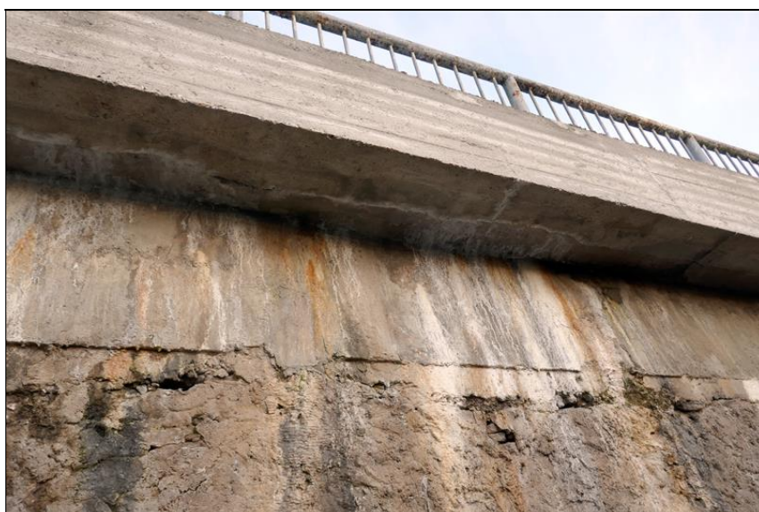
15_trhliny v rimse.jpg
