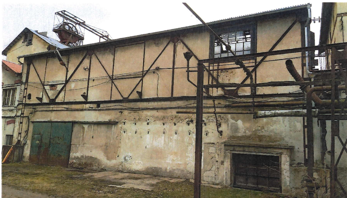
Obr. č. 9: Pohled z JV. Patrná je absence protikoroz. ochrany a otvor v JV zdi.
