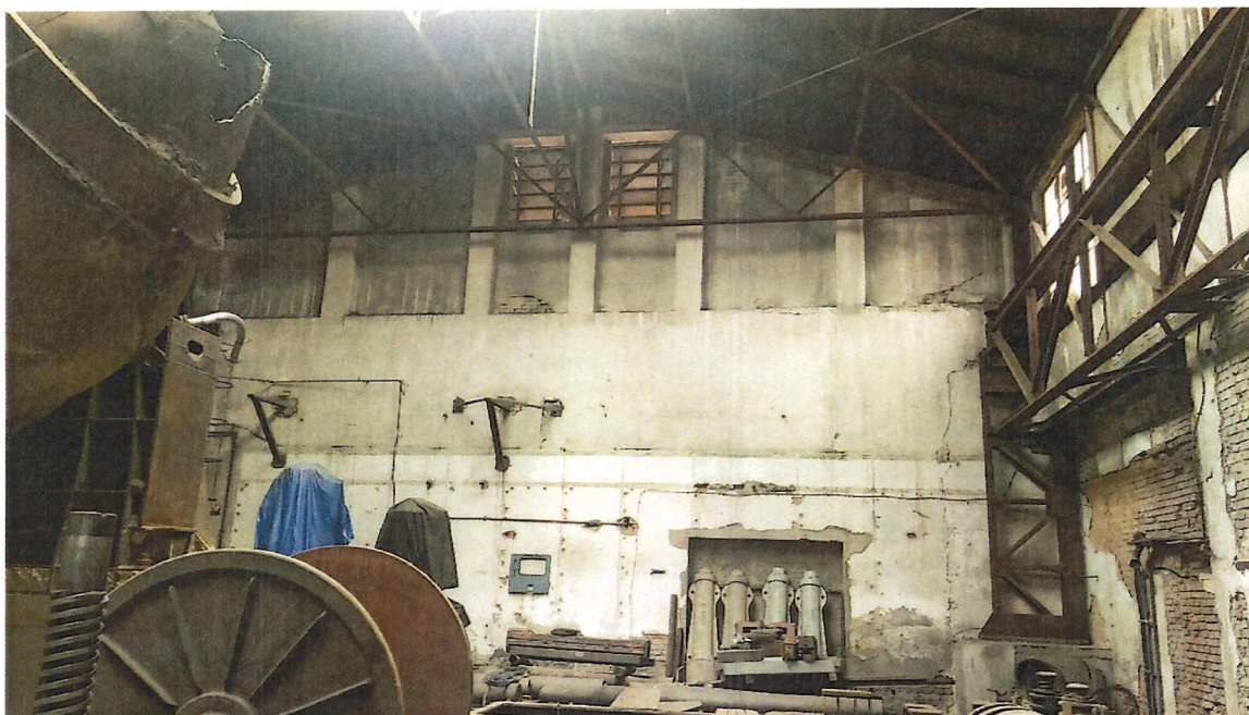
Obr. č. 5: Pohled na JZ štít. stěnu. Patrná je absence protikorozní ochrany.
