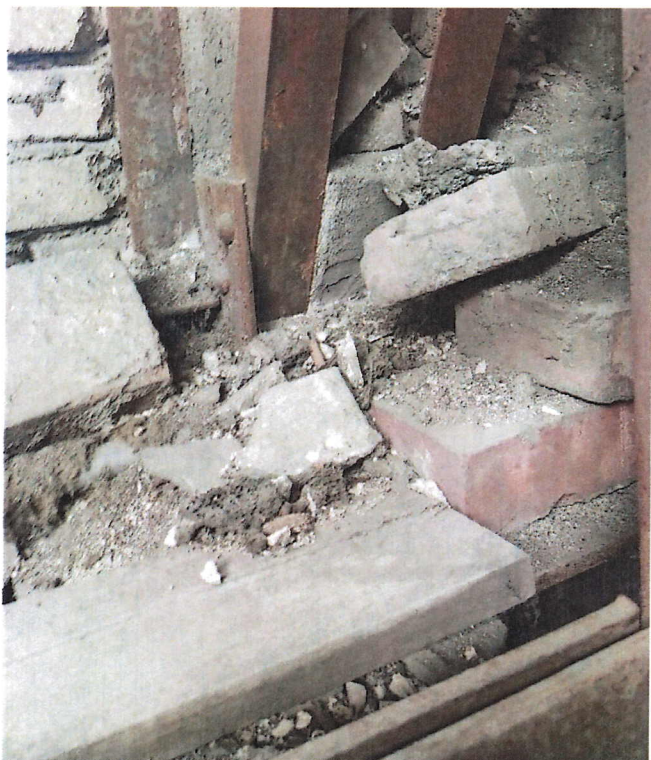
Obr. č. 14: Sloup v místě B1 na úrovni jeřábové dráhy. Patrné je zanesení sutí. Vyčistit dle doporučení iv) v bodě č. 7.
