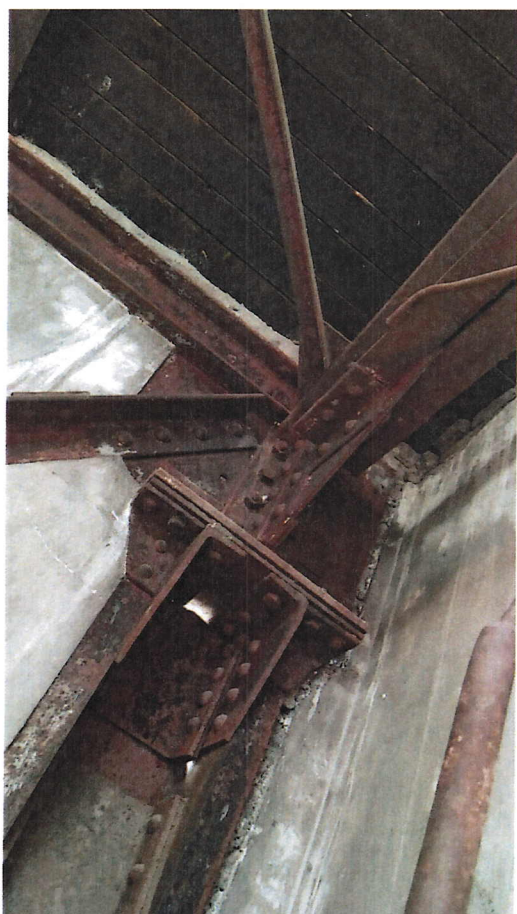
Obr. č. 10: Styčník nad B1 (JZ roh). Patrné jsou zbytky nátěrů.
