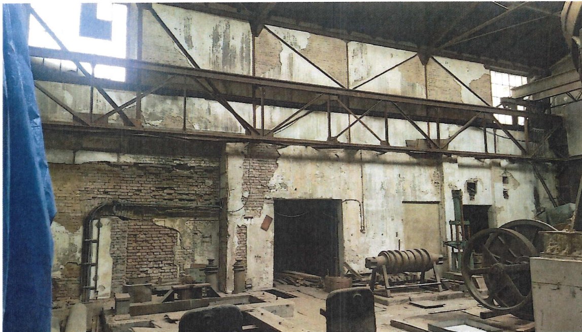
Obr. č. 7: Pohled na SZ stěnu. Patrná je absence protikorozní ochrany a poškození SZ zdi.
