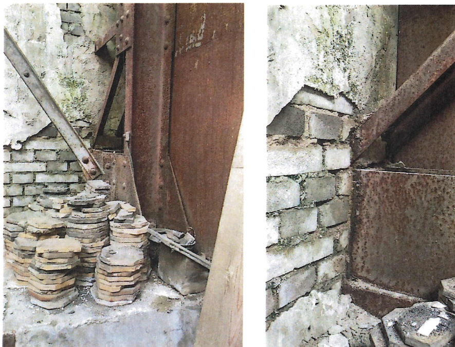
Obr. č. 13: Kotvení v místě A4 (SV). Není patrné poškození viditelných částí. Protikorozní ochrana chybí. Viz doporučení iii) z bodu 7. V detailu je patrné zhoršení koroze u zdiva a v zakrytých místech.
