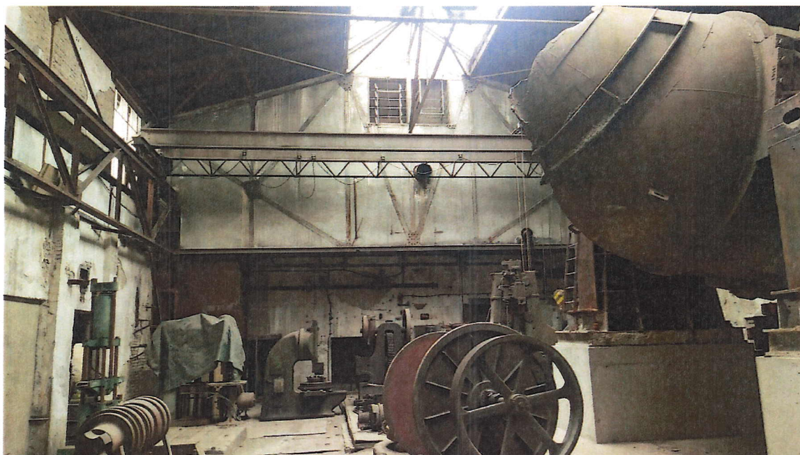
Obr. č. 6: Pohled na SV štít. stěnu a hrázděný příhrad. nosník. Patrná je absence protikorozní ochrany.
