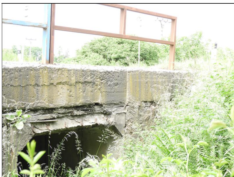
Pohled zleva na NK 1. pole. Rozpad izolačního systému, zbytky bednění, vegetace, stopy zatékání, hloubková degradace dobetonávky a nosníku, odpadávání kusů betonu, korodující, obnažená výztuž.
