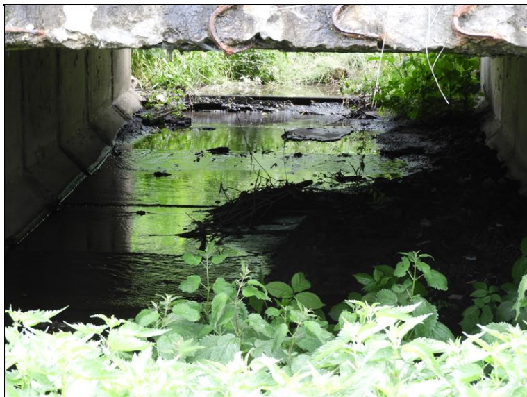
Území pod mostem, 2. pole. Koroze obnažené výztuže, krápníčky, stopy zatékání, degradace betonu.
