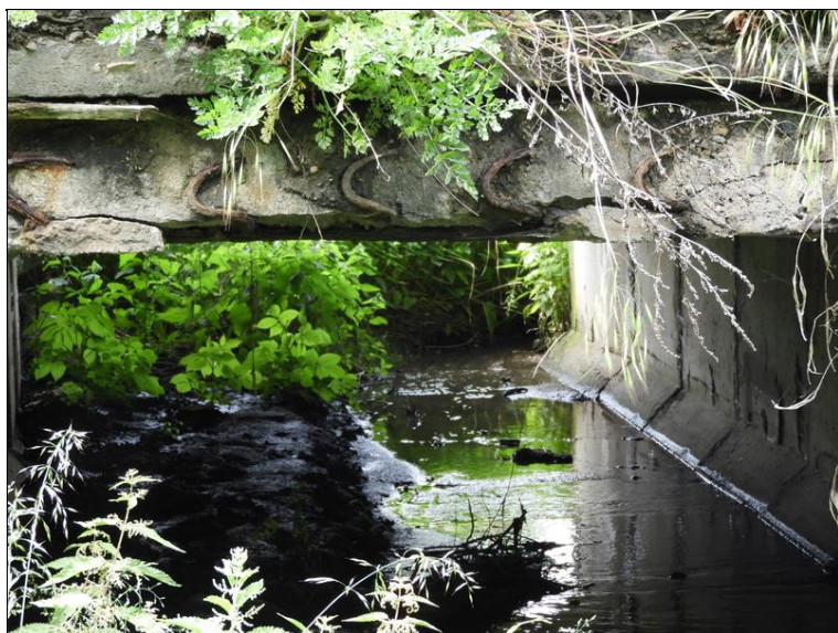
Pohled zleva na NK 2. pole. Degradace, rozpad betonu, koroze obnažené výztuže, průsaky ve spárách mezi nosníky, vegetace.
