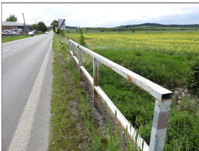
Pravá římsa a zábradlí. Degradace betonu římsy, koruna vozovky nad úrovní římsy - odtoky srážkové vody přes římsy, zatékání na nosníky. Koroze ocelového zábradlí. Nánosy nečistot a vegetace.
