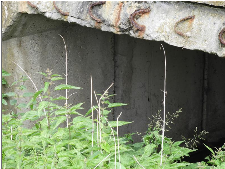
OP1 zprava. Trhlina v nosné konstrukci. Stopy po zatékání a výluhy ve spáře mezi prvním a druhým nosníkem zprava.
