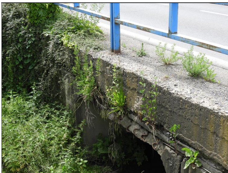
OP3 zleva. Vegetace, obnažená, zkorodovaná výztuž, zatékání.
